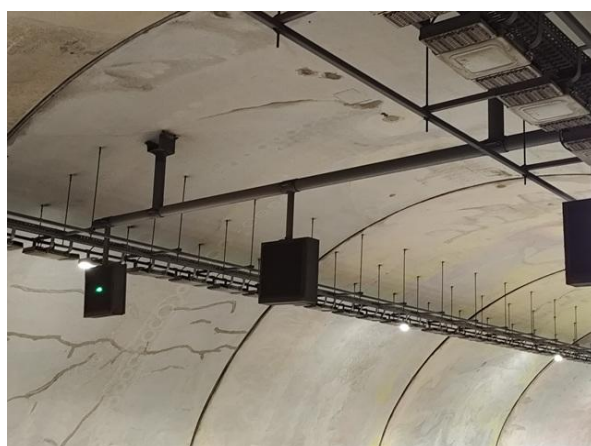
신호기, 조명시설 전경
